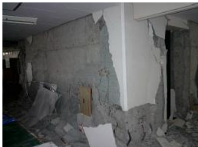
○耐力壁のせん断破壊
