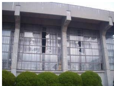
○ガラスの破損
