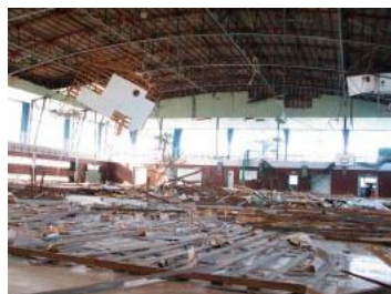
○天井や照明の落下
