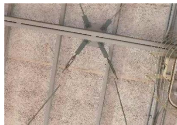
○破断した天井ブレース
