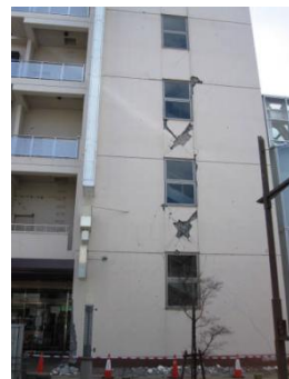
○連層壁のせん断ひび割れ
