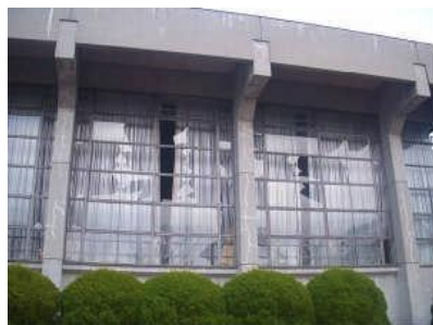
○ガラスの破損
