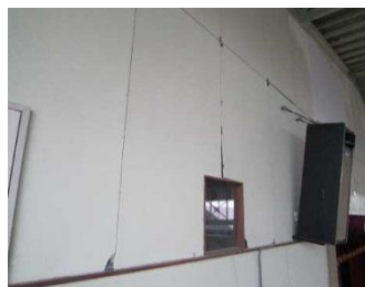
○内装材のずれ
