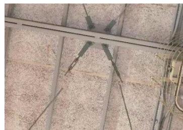
○破断した天井ブレース
