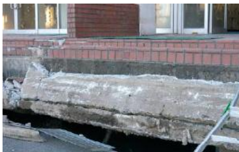
○地盤沈下による段差
