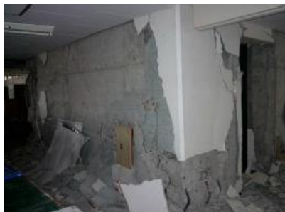
○耐力壁のせん断破壊
