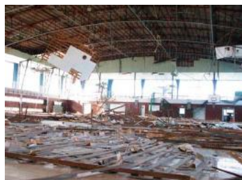
○天井や照明の落下
