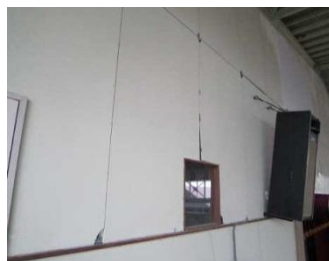
○内装材のずれ
