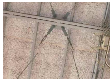
○破断した天井ブレース
