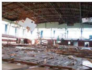
○天井や照明の落下
