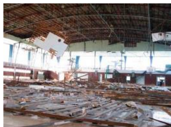
○天井や照明の落下
