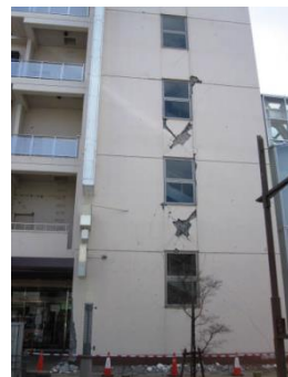
○連層壁のせん断ひび割れ
