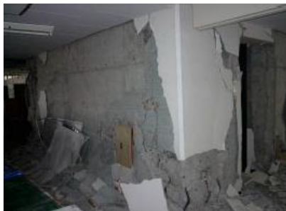
○耐力壁のせん断破壊
