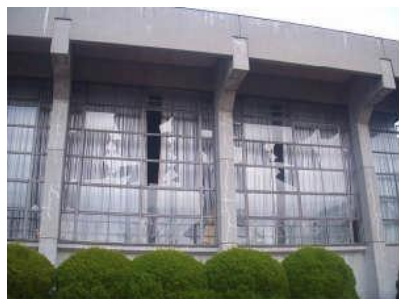
○ガラスの破損
