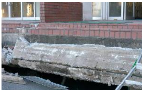
○地盤沈下による段差
