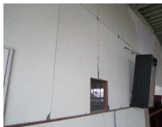
○内装材のずれ
