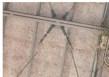
○破断した天井ブレース
