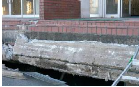
○地盤沈下による段差
