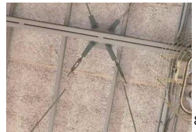
○破断した天井ブレース
