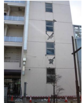
○連層壁のせん断ひび割れ
