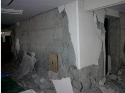
○耐力壁のせん断破壊
