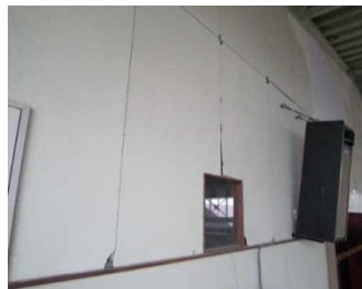
○内装材のずれ
