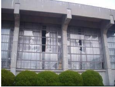
○ガラスの破損
