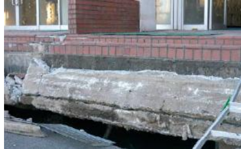
○地盤沈下による段差
