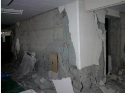
○耐力壁のせん断破壊
