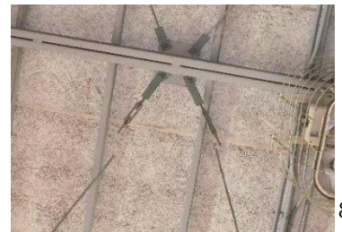
○破断した天井ブレース
