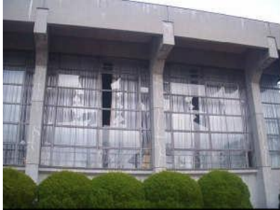
○ガラスの破損
