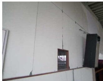
○内装材のずれ
