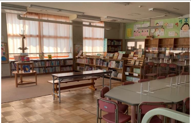
中棟 図書室 本棚が多数あり、転倒のおそれあり 使用前に状況確認する必要あり
