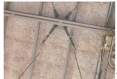
○破断した天井ブレース
