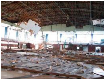
○天井や照明の落下
