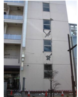
○連層壁のせん断ひび割れ
