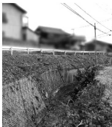
▲ 急がれる崩落防止対策
